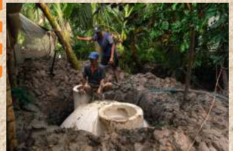
Installation von Biogasgruben in Vietnam.
